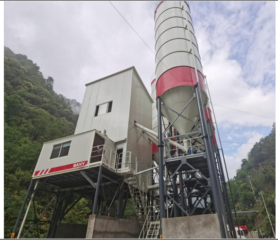
项目区搅拌站
