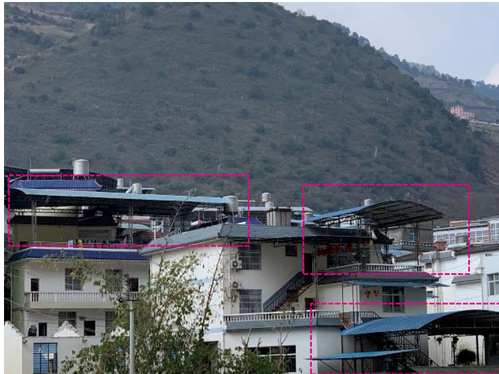
搭建高度超出主体建筑——自建房 向阳南路临街商铺搭建超出主体建筑高度约3米。
